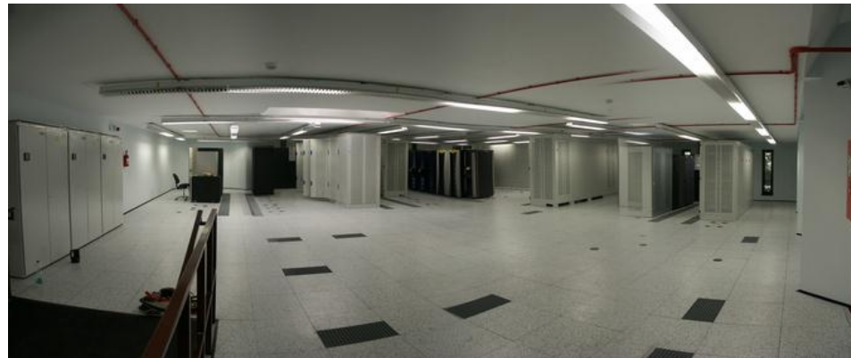
Serwerownia w PCSS
